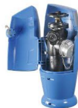
P.E.I. sous pression ou hydrants
